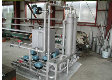
ユニット配管
