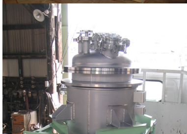
メタノールタンク
