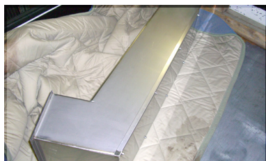
電線用ダクト
