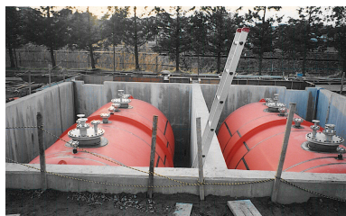
■ 地下埋設貯蔵タンク
